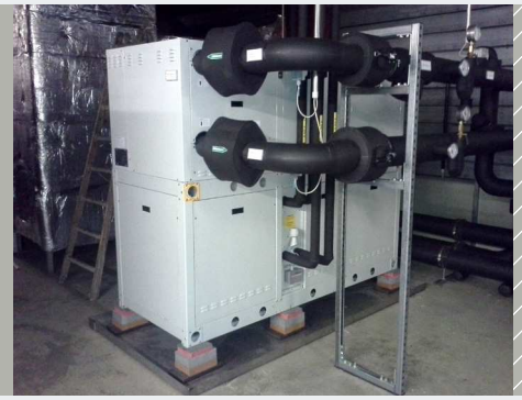
Posadowienie agregatu chłodniczego na izolatorach Isotop® SE-DE
