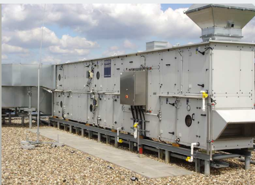
Sprężyste posadowienie urządzeń wentylacyjno-klimatyzacyjnych
