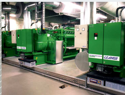
Sprężyste posadowienie agregatów kogeneracyjnych
