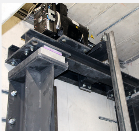
Dwustronnie sprężyste posadowienie na izolatorach Isotop® SE-DE, napęd w górnej części szybu
