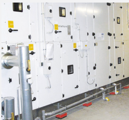
Instalacja wentylacyjno-klimatyzacyjna obok pomieszczeń biurowych, izolowana za pomocą wibroizolatorów Isotop® SE
